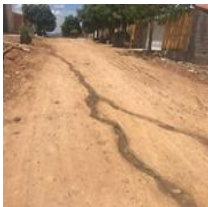
Figura 7 – Disposição de esgoto doméstico à céu aberto em rua no bairro de Nova Pau dos Ferros, Rio Grande do Norte, Brasil
