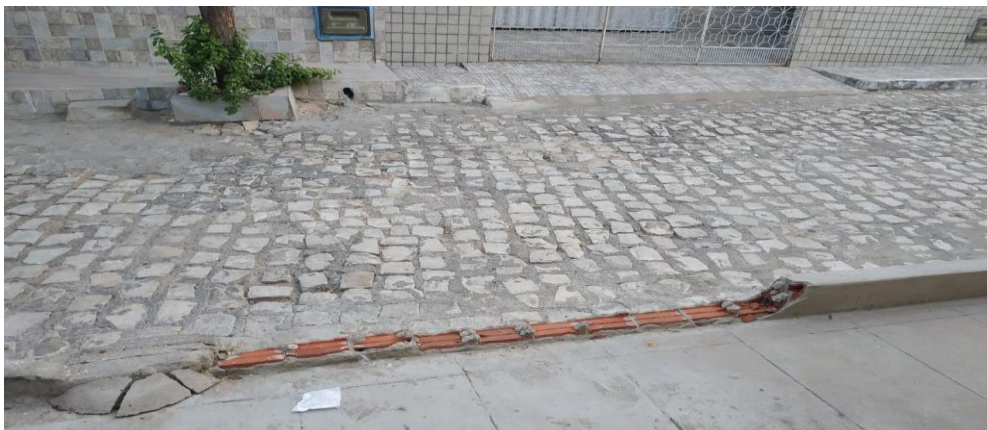
Figura 8 – Avarias no calçamento e meio-fio em rua no bairro São Benedito, em Pau dos Ferros, Rio Grande do Norte, Brasil
