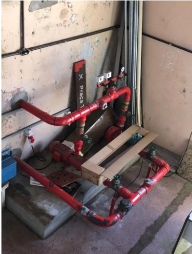
FIGURA 13 - Sistema de bombas inoperante
