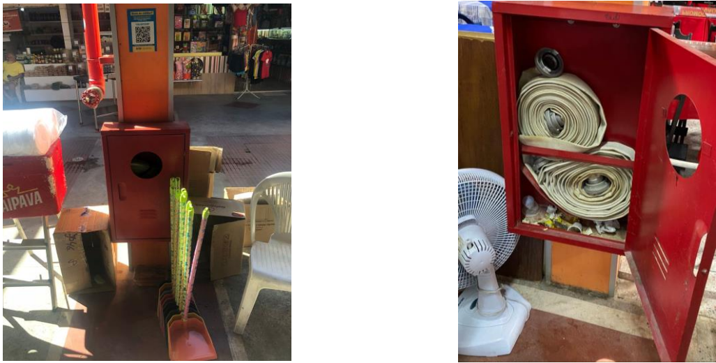
FIGURA 12 - Bocas de incêndio obstruídas
