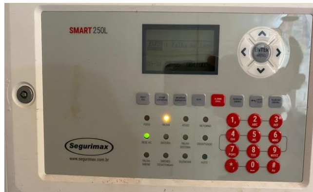
FIGURA 15- Central de alarme sem funcionar
