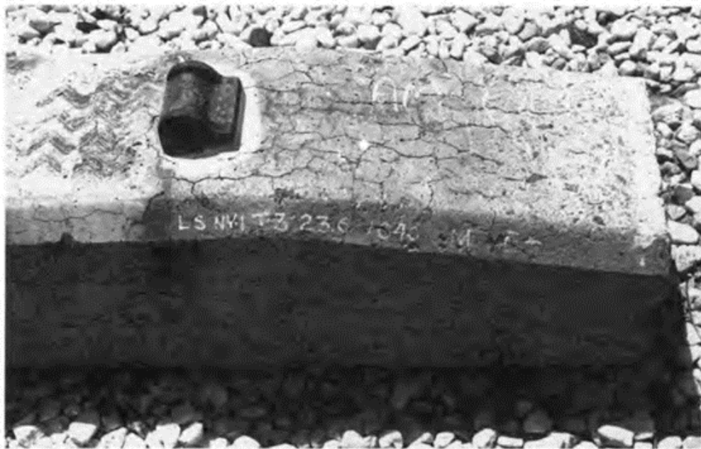
Figura 28 – Dormente com fissuração decorrente de DEF
