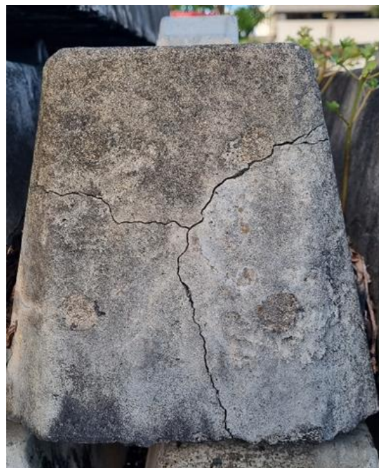
Figura 46 – Fissuras tipo “mapa” na extremidade dos dormentes do estoque
