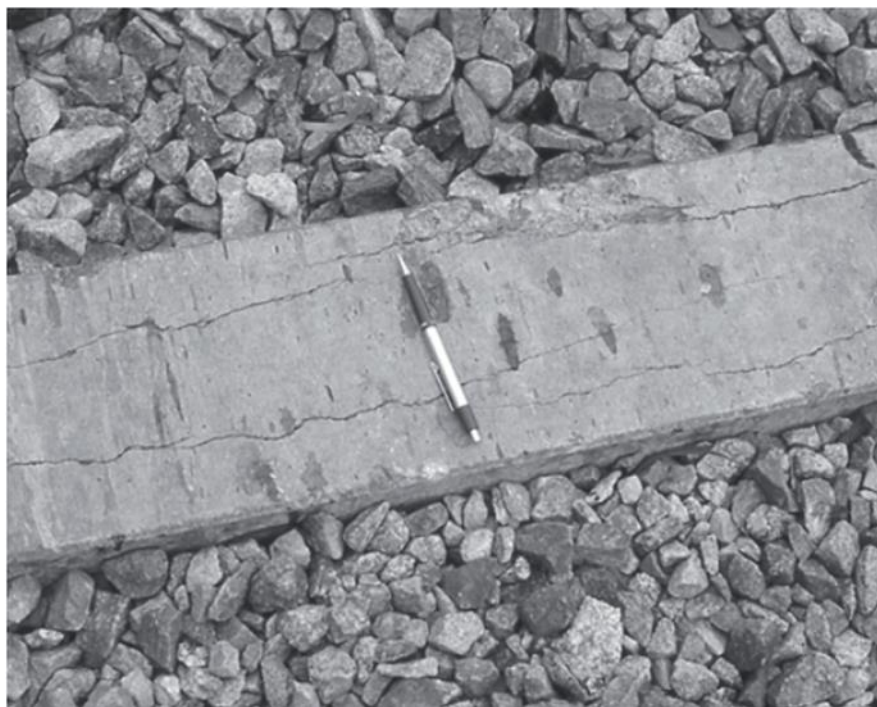
Figura 26 – Fissuras superficiais em dormente de concreto protendido
