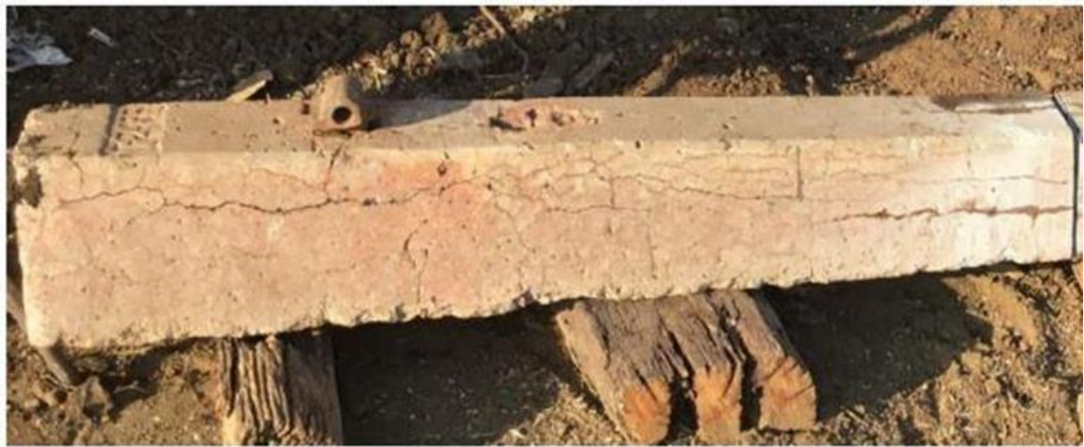
Figura 29 – Dormente com fissuração longitudinal decorrente de DEF
