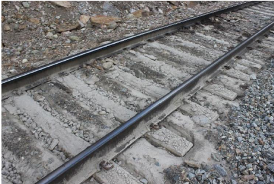
Figura 36 – Desgaste superficial do dormente de concreto e lastro contaminado
