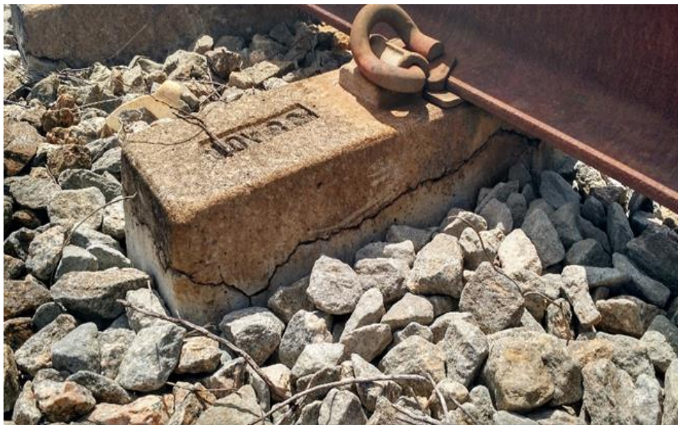
Figura 39 – Fissura longitudinal na face lateral do dormente
