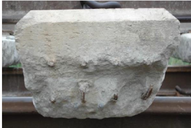
Figura 35 – Efeito da abrasão do concreto em um dormente de concreto
