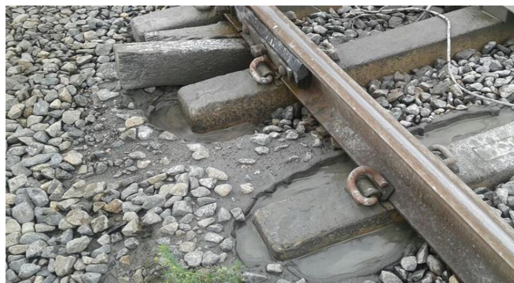
Figura 4 – Exemplo lastro colmatado
