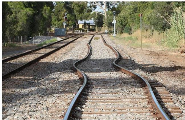
Figura 3 – Ocorrência de flambagem lateral em trilhos
