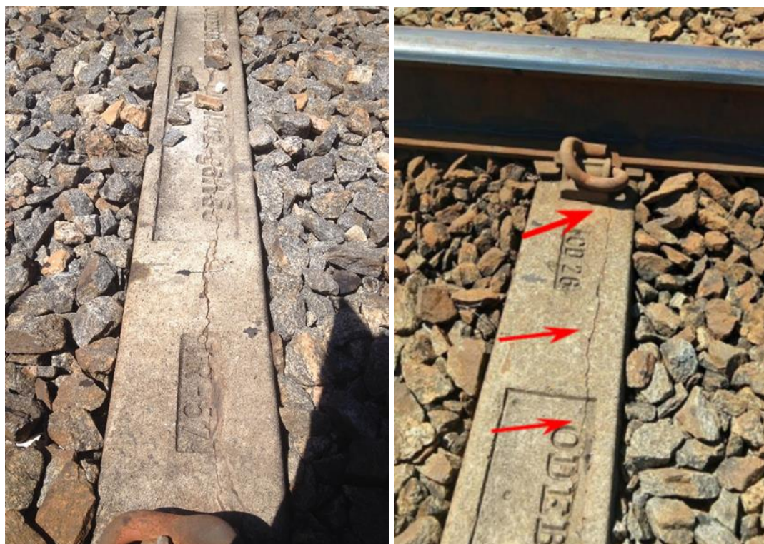
Figura 40 – Fissuras longitudinais na face superior do dormente
