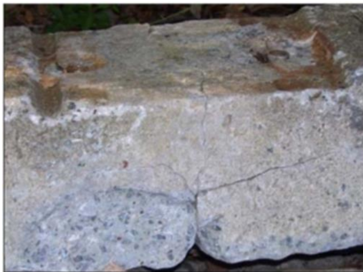
Figura 32 – Fissuras na região de apoio dos trilhos no dormente de concreto
