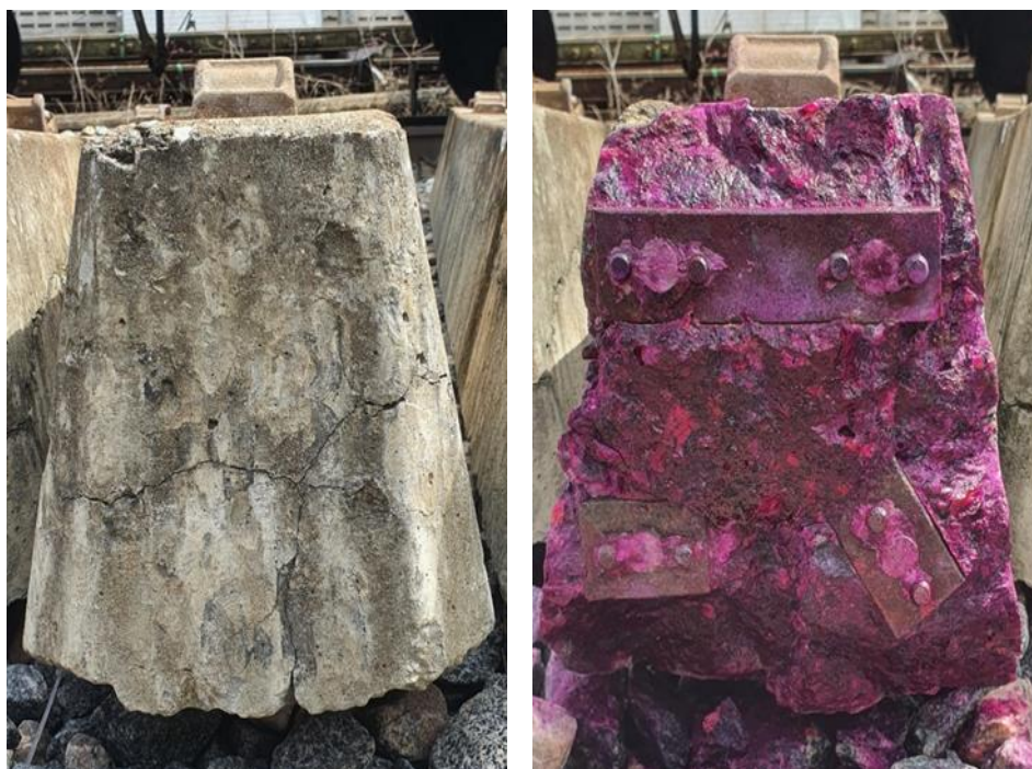
Figura 60 – Ensaio de carbonatação na extremidade do dormente nº 02
