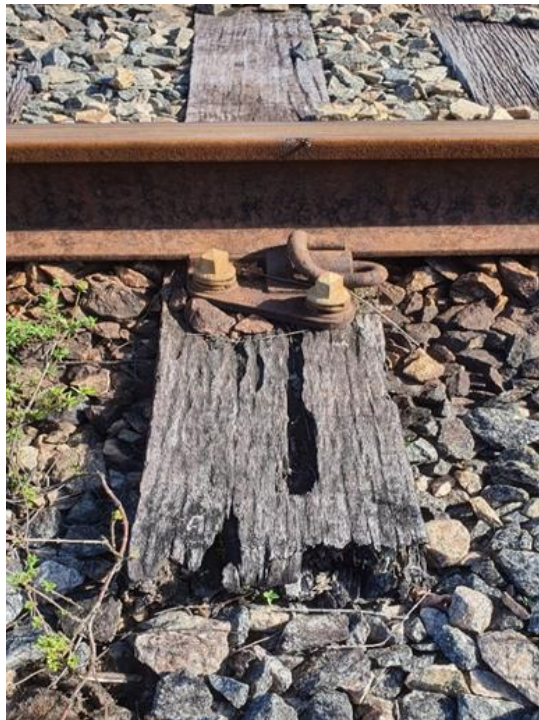
Figura 8 – Dormente de madeira degradado
