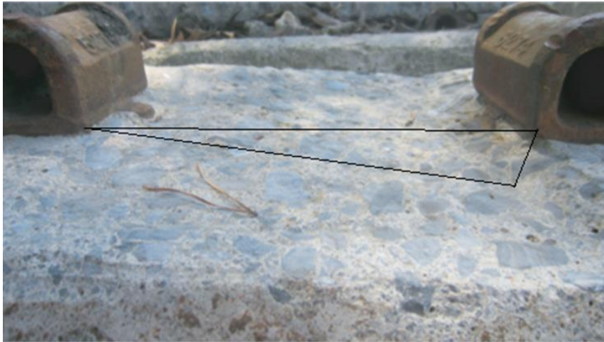
Figura 31 – Desgaste superficial do concreto (RSD) com formato triangular
