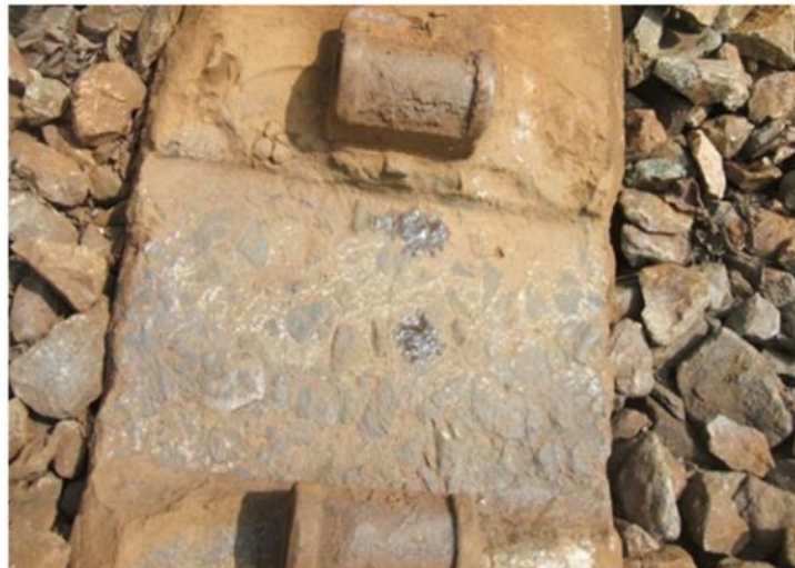
Figura 30 – Deterioração da região do apoio dos trilhos (RSD)
