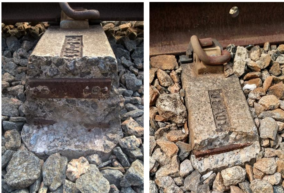
Figura 42 – Dormentes apresentando ruptura da extremidade e ferragem exposta
