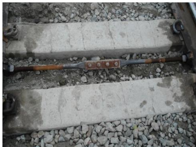
Figura 33 – Dormentes fissurados no meio do vão
