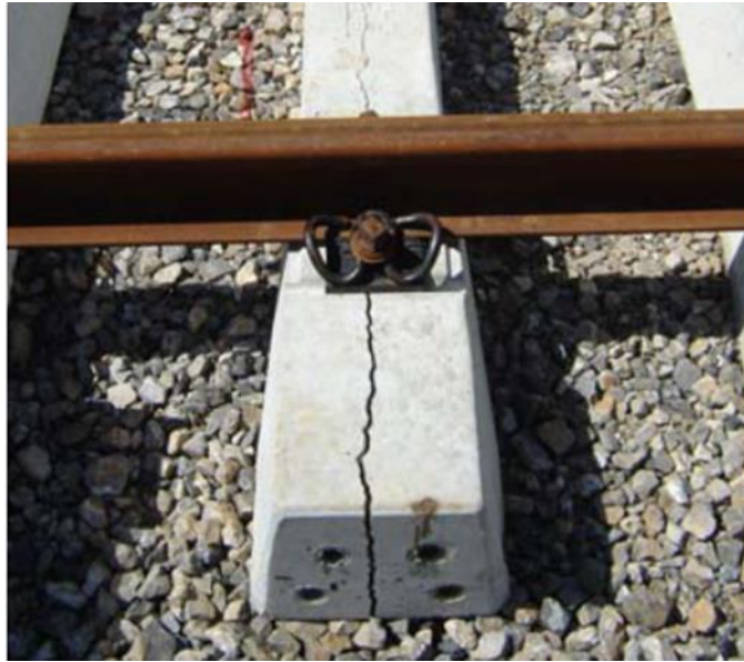
Figura 25 – Fissura longitudinal decorrente de má execução do sistema de fixação do dormente
