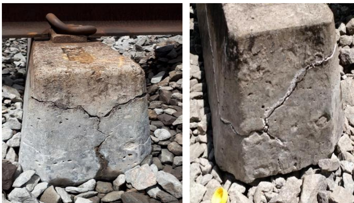
Figura 41 – Fissura tipo “mapa” na extremidade dos dormentes
