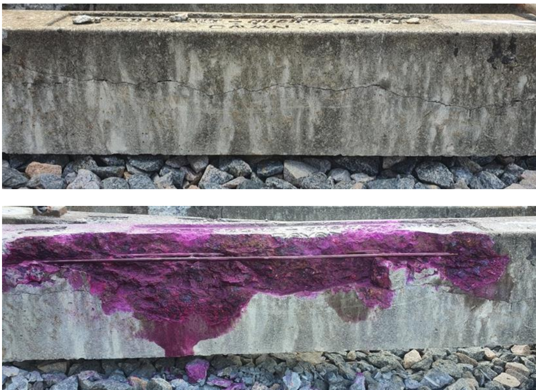
Figura 62 – Ensaio de carbonatação na lateral do dormente nº 01
