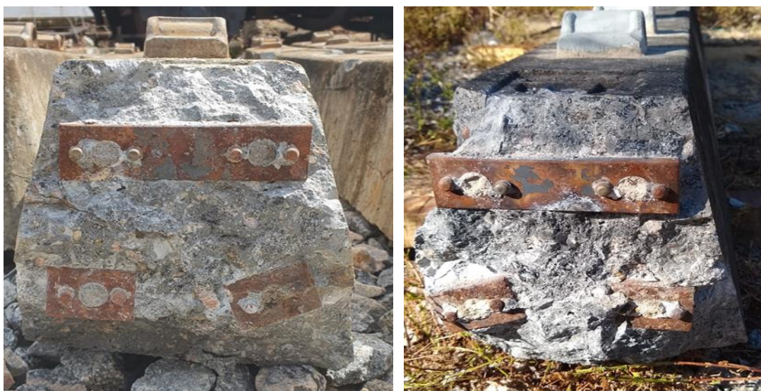
Figura 55 – Chapas de ancoragem de protensão com sinais de corrosão
