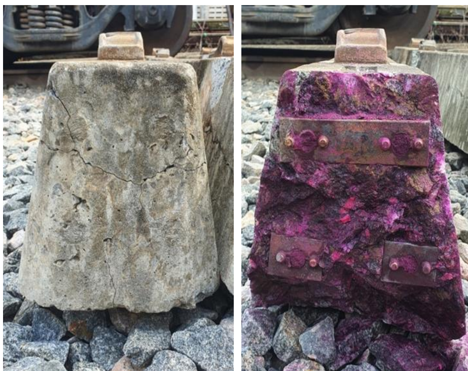
Figura 59 – Ensaio de carbonatação na extremidade do dormente nº 01
