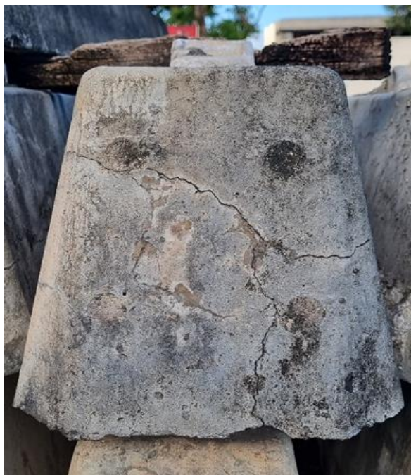
Figura 45 – Fissuras tipo “mapa” na extremidade dos dormentes do estoque
