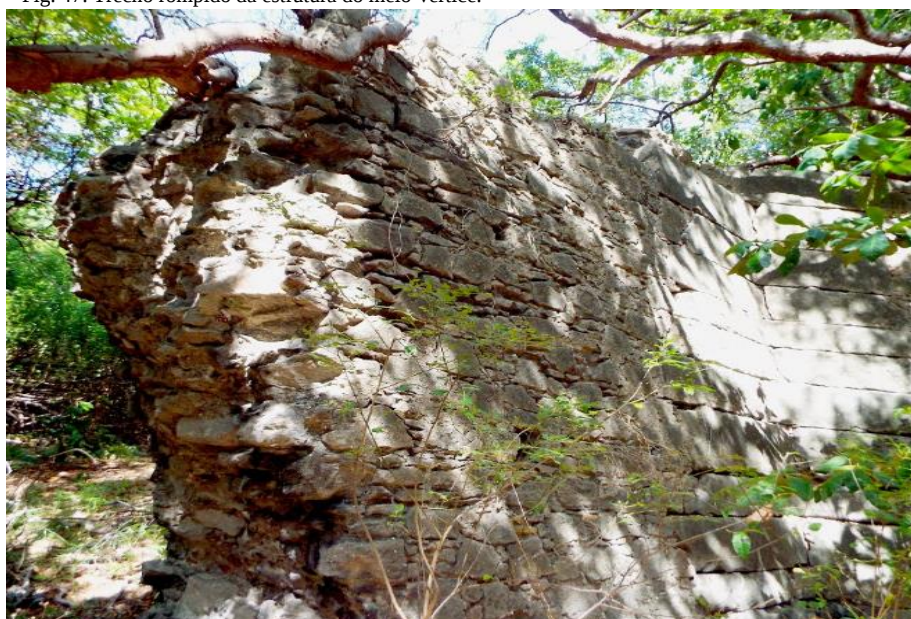
Fig. 47. Trecho rompido da estrutura do meio-vértice.
