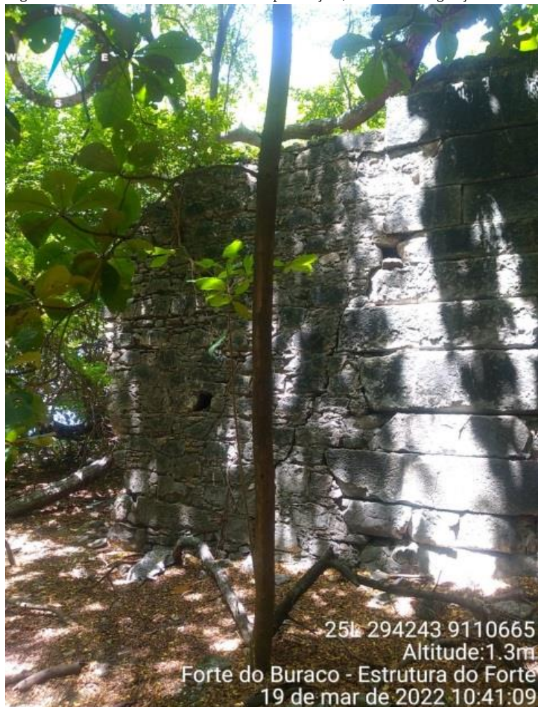
Fig. 46. Remanescente do meio-vértice com perfurações, rachadura e vegetação invasiva.
