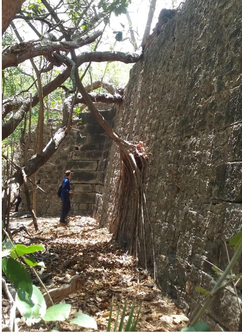
Fig. 45. Muralha norte e início do meio-vértice com presença de enraizamento na face externa.
