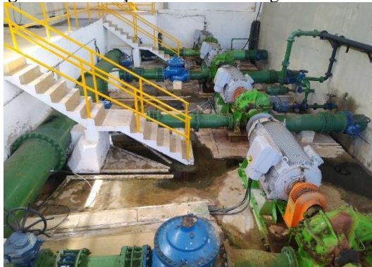
Fotografia 3 – Estação Elevatória de Água Bruta Prata - 1
