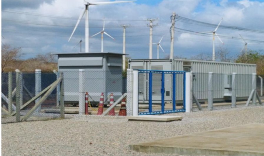
Figura 12 – Local de Instalação do BESS.
