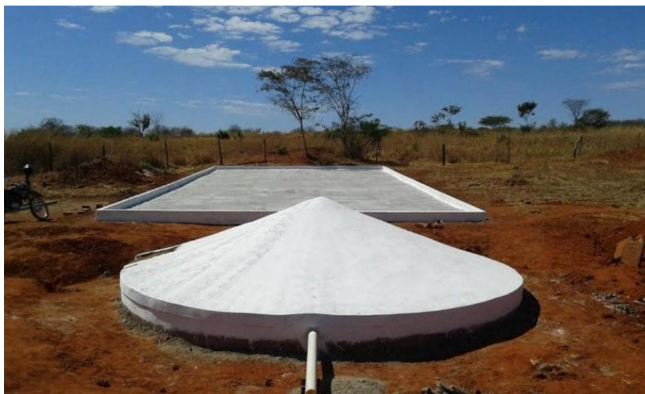
Figura 4 - Cisterna para armazenamento de água pluvial com captação por piso.
