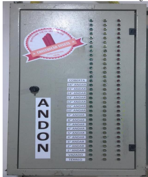
Figura 44 – Painel Andon instalado na sala de engenharia
