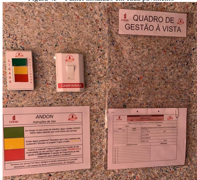
Figura 45 – Painel instalado em cada pavimento
