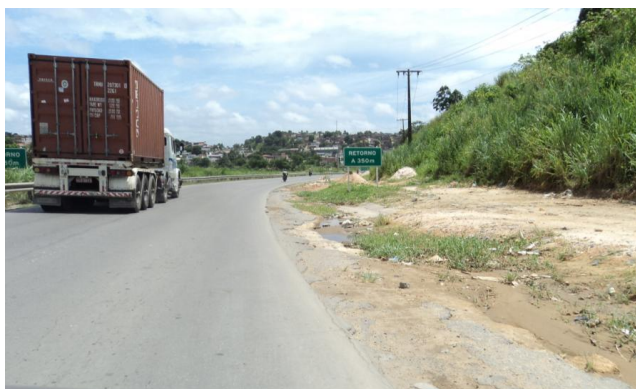
Figura 9: Sistema de drenagem ineficiente. Fonte: Autores
