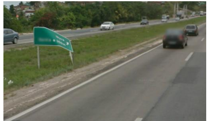
Figura 5: Sinalização Vertical danificada. Fonte: Google maps
