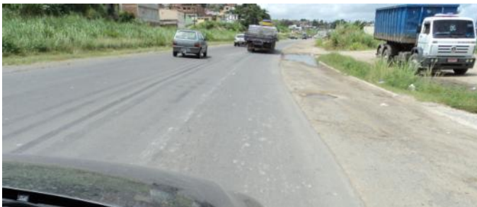
Figura 6: Sinalização Horizontal encoberta ou apagada. Fonte autores
