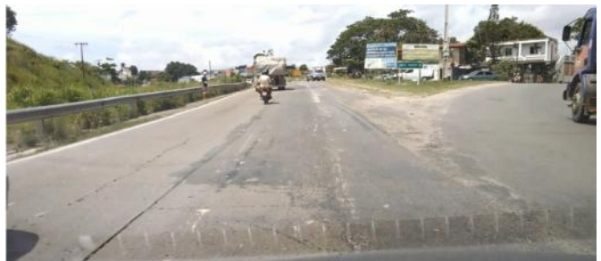
Figura 7: Sinalização Horizontal encoberta ou apagada. Fonte: Autores
