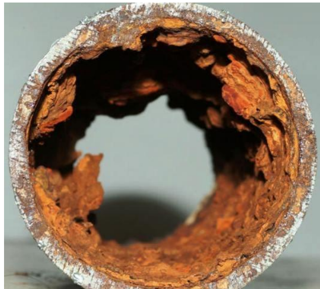
Figura 6 - Corrosão em tubo de aço.
