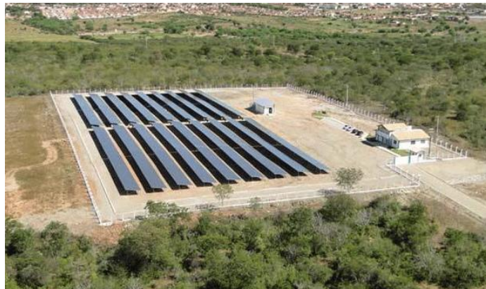
Figura 2.2. Usina solar fotovoltaica de Tauá-CE.
