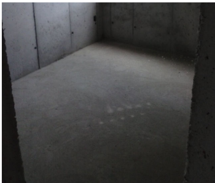
Foto 8 - Contrapiso com deformação por conta da Tapping Machine
