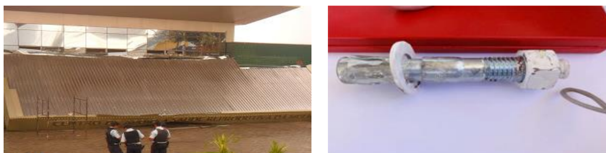
Figura 3.8 – Queda da marquise do HRN e chumbador expansivo utilizado.
