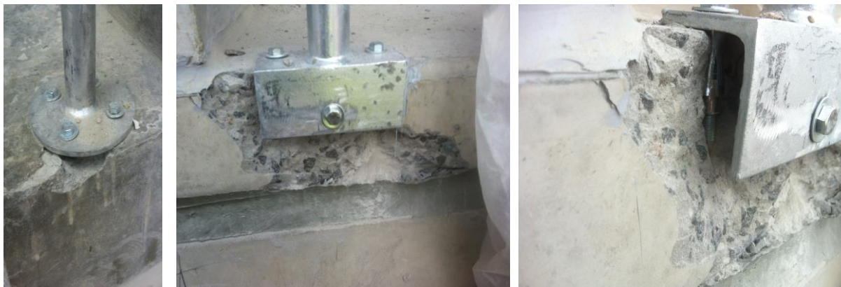
Figura 3.3 – Quebra lateral do concreto devido a proximidade a borda.
