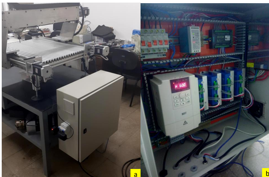
Figura 44 - Quadro de comando instalado na router
