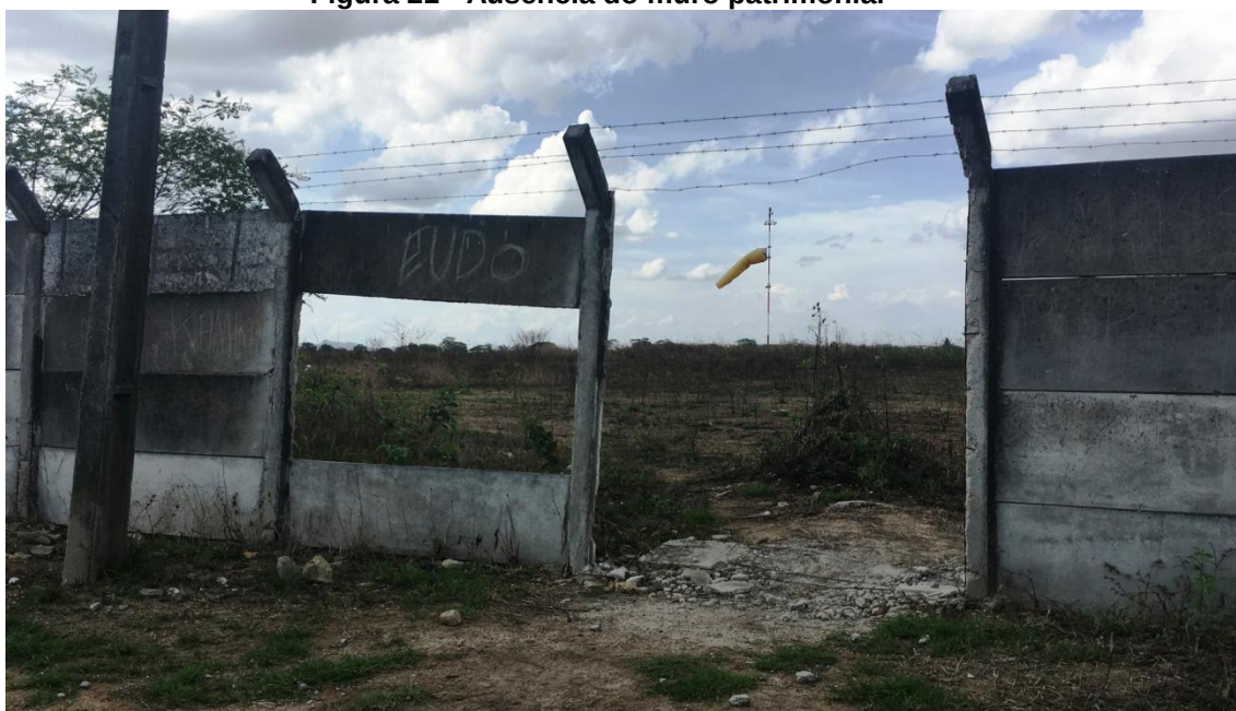
Figura 21 - Ausência do muro patrimonial
