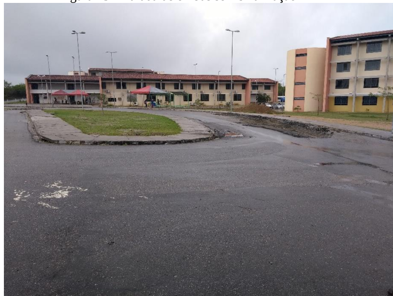
Figura 43 – Parada de ônibus sem sinalização
