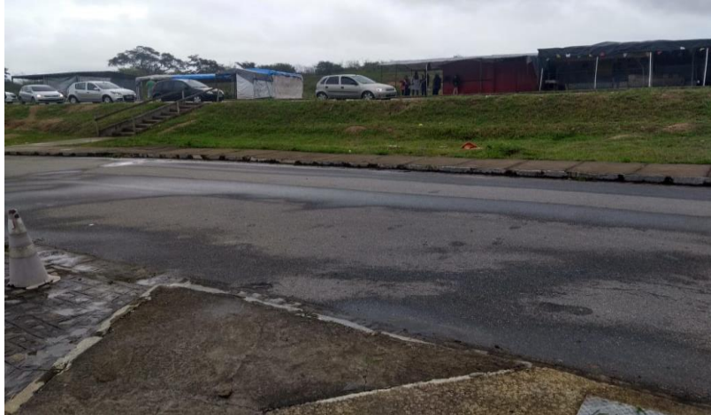
Figura 62 – Falta de sinalização na passagem em direção às barracas de lanche
