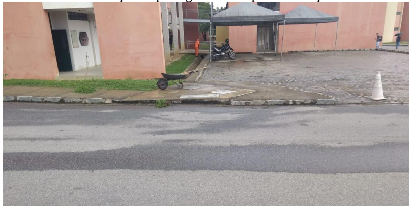
Figura 63 – Falta de sinalização da passagem do campus em direção às barracas de lanche
