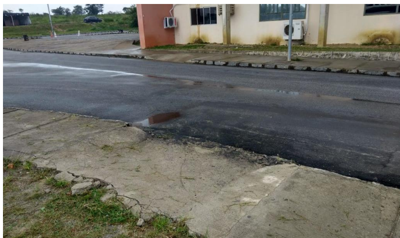
Figura 61 – Falta de sinalização na passagem para biblioteca
