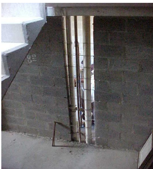
Figura 10: Detalhe de “shaft” interrompendo a parede
