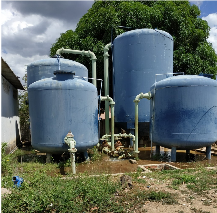
Figura 14 – ETA compacta e pressurizada de Orocó.
