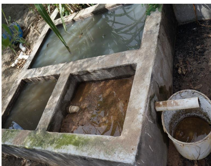
FIGURA 7: Filtro de águas cinzas
