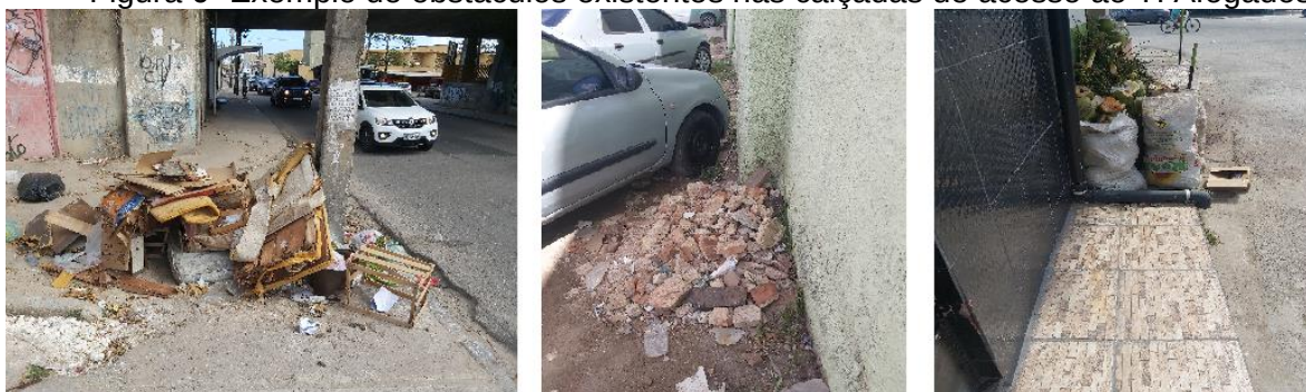
Figura 6 -Exemplo de obstáculos existentes nas calçadas de acesso ao TI Afogados.
