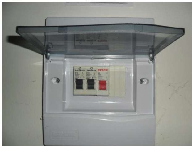
Figura 21: Quadro de distribuição.
