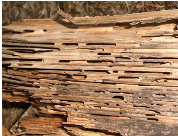
Figura 7: Madeira deteriorada por cupim.
