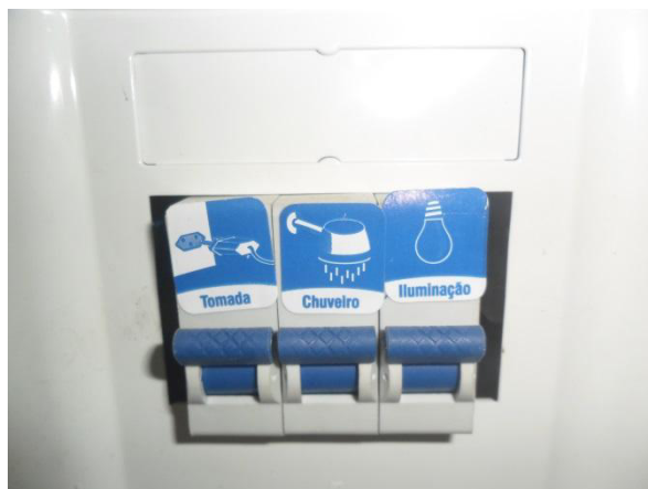
Figura 13:Quadro de distribuição.
