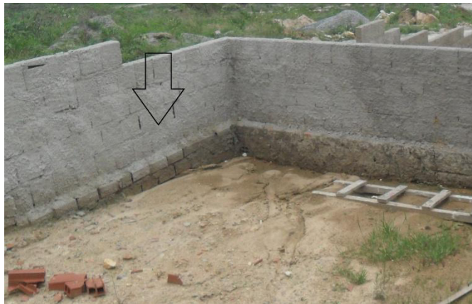
Figura 25: Alvenaria apoiada sobre tijolos.
