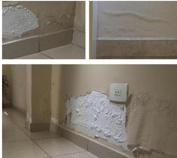
Figura 6: Umidade Ascendente em Paredes.
