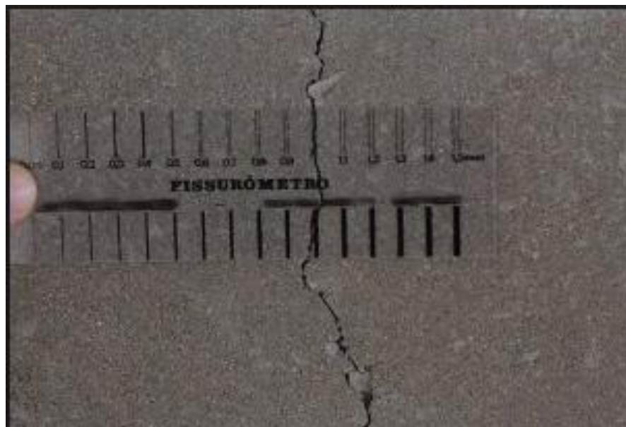
Figura 2: Fissuras em elemento estrutural
