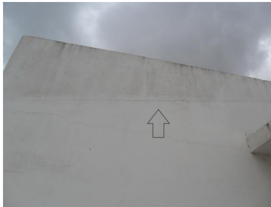
Figura 24: Fissuras causadas por rotação da laje.
