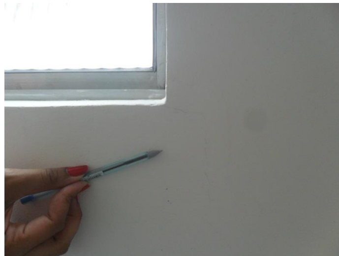
Figura 17: Fissuras pela ausência de vergas na alvenaria.
