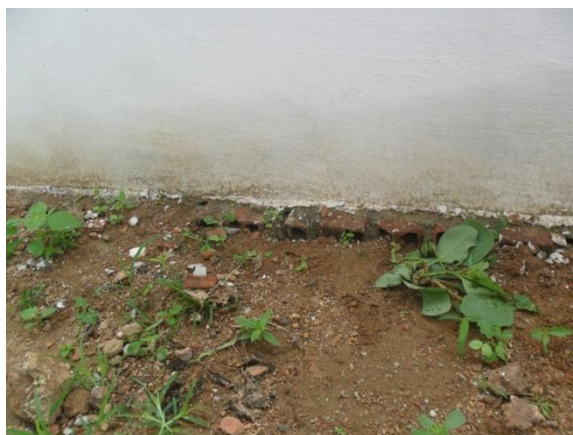
Figura 16: Alvenaria apoiada sobre tijolos.
