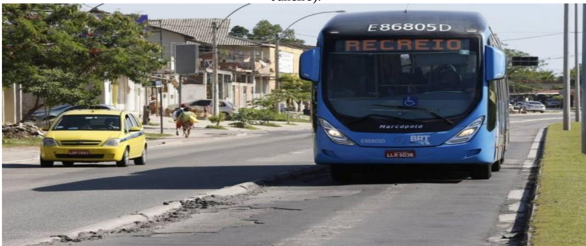
Figura 27 - Danos causados ao pavimento da faixa exclusiva do BRT do Corredor Transoeste (Rio de Janeiro).
