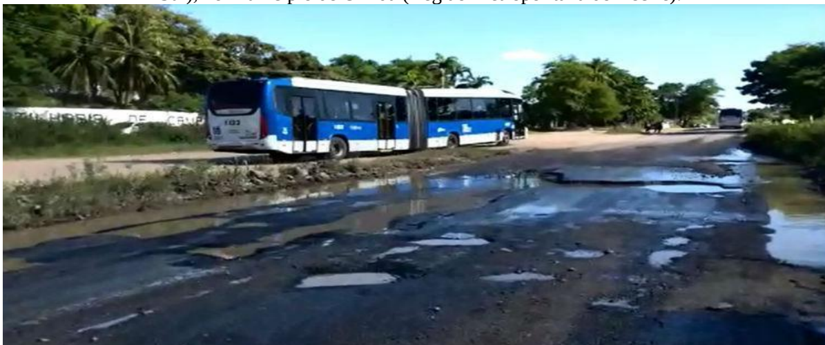
Figura 26 - Danos causados ao pavimento da faixa exclusiva do BRT do Corredor da PE-15 (Norte-Sul), no Município de Olinda (Região Metropolitana do Recife).
