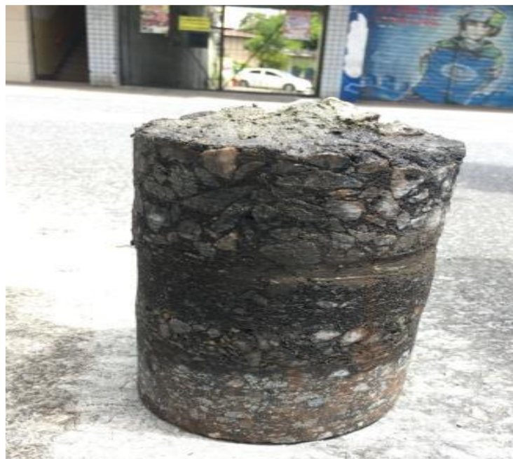
Figura 74 - Testemunho extraído do revestimento asfáltico da avenida Caxangá por meio de sondagem rotativa.
