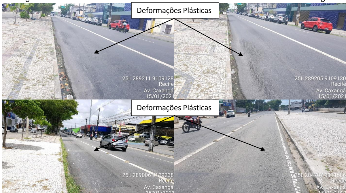
Figura 94 - Fotos de defeitos característicos na faixa exclusiva do BRT na avenida Caxangá.
