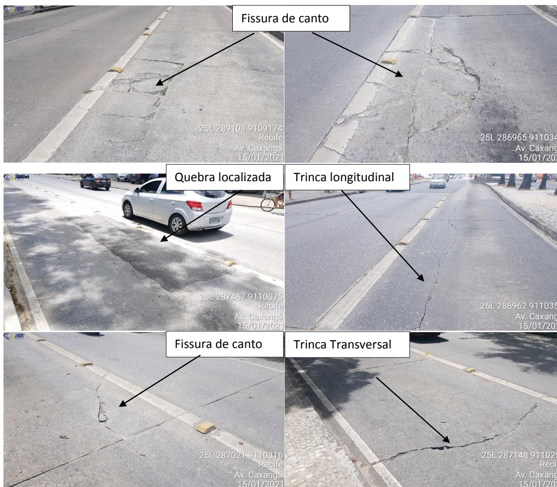
Figura 91 - Fotos de alguns dos defeitos característicos na avenida Caxangá, sentido leste.
