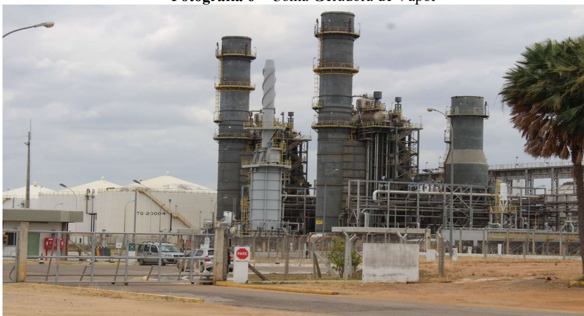
Fotografia 6 – Usina Geradora de Vapor
