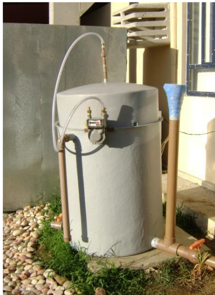
Figura 1- Biodigestor de resíduos sólidos, instalado no Laboratório de Engenharia Ambiental (LEA), UFPE-Campos do Agreste, Caruaru.
