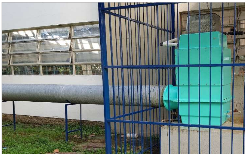
Figura 9 - Duto de entrada de ar
