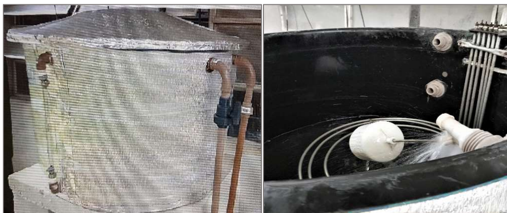
Figura 7 - Reservatório de água quente e a resistência elétrica
