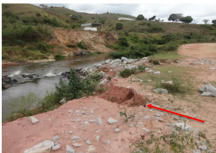
Figura 22 – Processo erosivo na margem direita do rio Pirangi, logo após o trecho onde será feito o barramento
