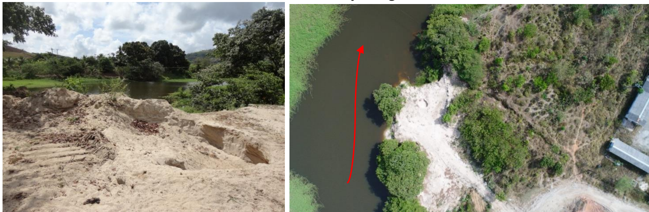
Figura 39 – Trecho da margem direita do rio Una, à jusante da barragem Serro Azul, após a ponte de acesso com evidências de extração ilegal de areia
