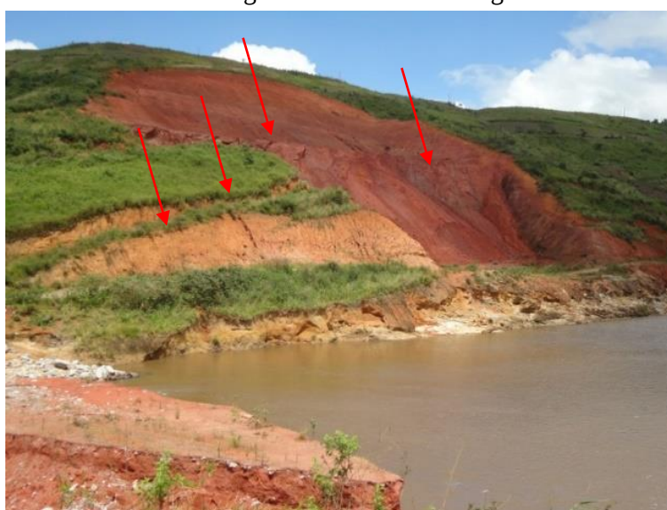
Figura 21 – Área da ombreira da barragem com a ocorrência de processos erosivos (ravinas), situada na margem direita do rio Pirangi
