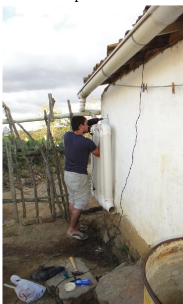
(c) Aluno pesquisador instalando o dispositivo.
