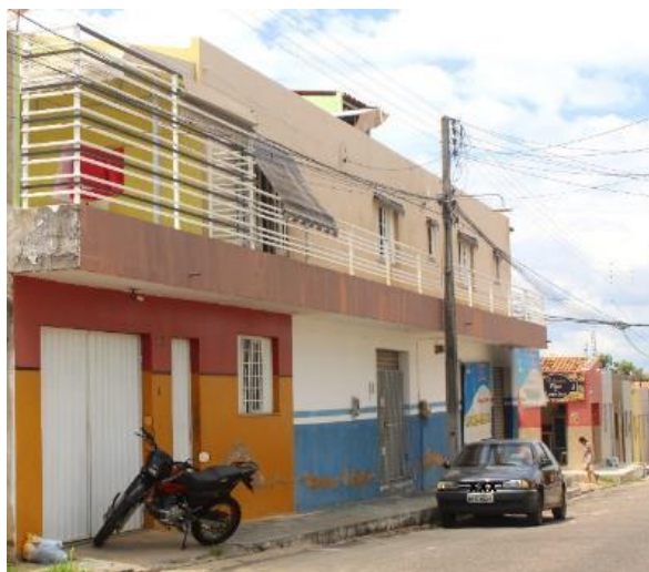
Fotografia 27 - Construção de marquise e obstrução da calçada
