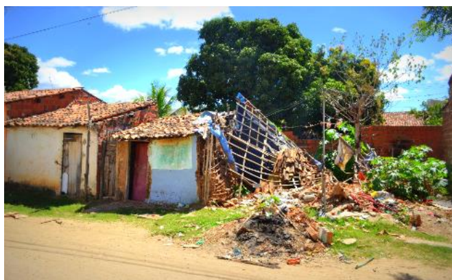
Fotografia 46 - Moradia Precária no bairro Triângulo
