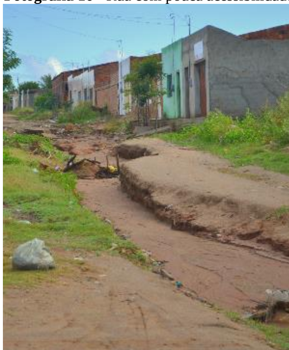
Fotografia 16 - Rua com pouca acessibilidade
