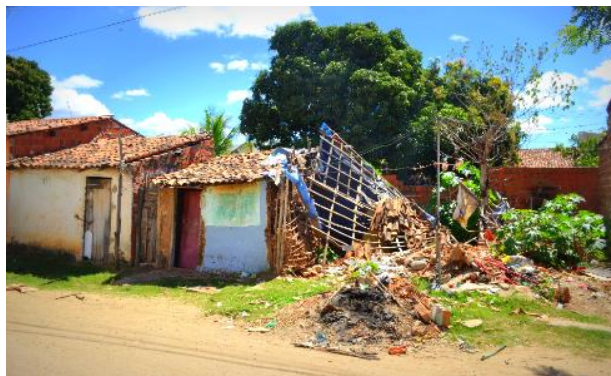
Fotografia 51 - Moradia Precária no bairro Triângulo
