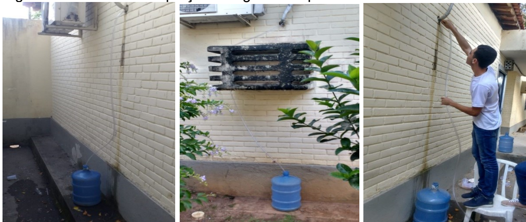
Figura 3: Sistemas de captação de água dos aparelhos de ar-condicionado.
