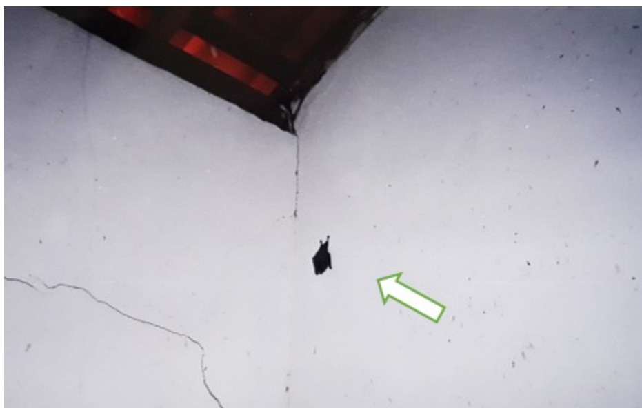
Figura 12: Morcego em parede no interior de residência.
