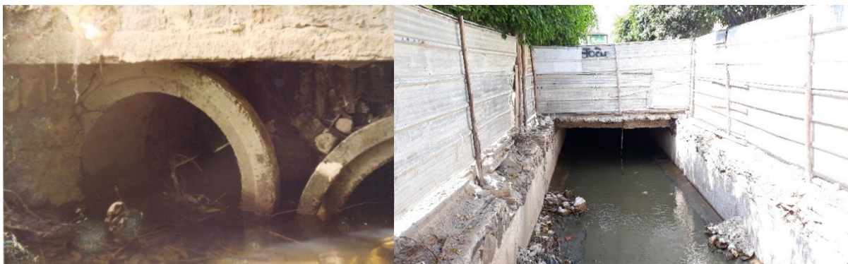
Figura 20: Galerias de esgoto abertos.
