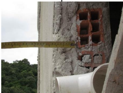
Figura 5 - Espessura do emboço maior que 3cm
