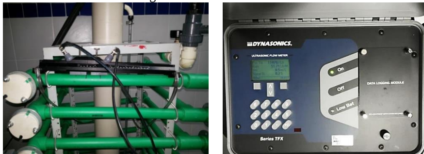
Figura 27 - Medidor de vazão
