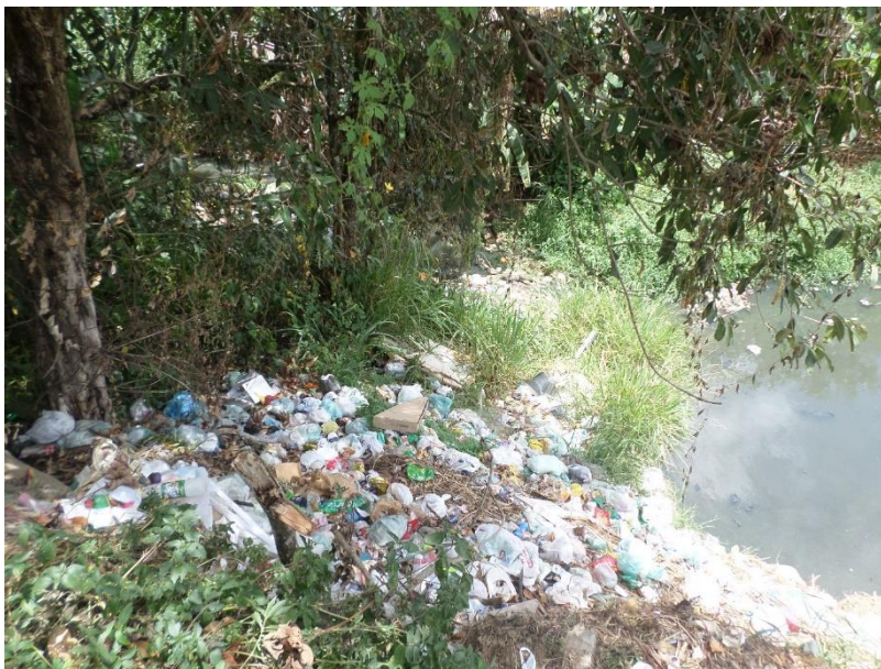
Figura 5 - Lixo e vegetação ocupando o leito do canal.
