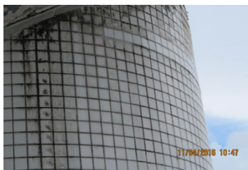
Figura 16 - Mancha de lodo e bolor em fachada
