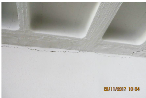
Figura 9 - Fissura na interface concreto x alvenaria
