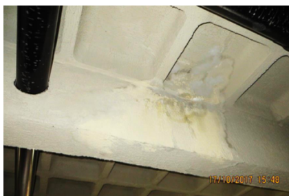
Figura 7 - Mancha de infiltração em laje
