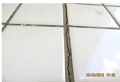
Figura 12 - Fissura em argamassa de rejunte
