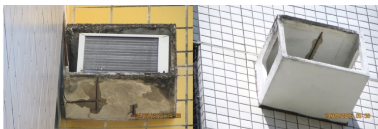
Figura 15 - Corrosão de armadura em caixas pré moldadas de ar condicionado
