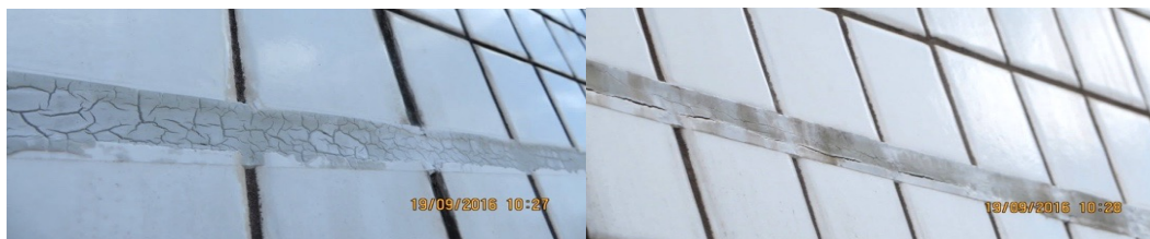
Figura 14 - Craquelamento em junta de dilatação
