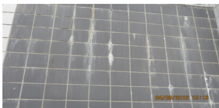
Figura 13 - Manchas de eflorescência em fachada
