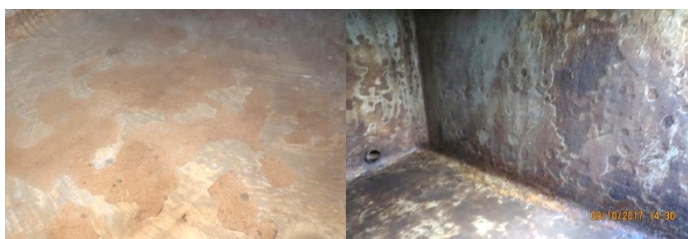
Figura 22 - Degradação de sistema impermeabilizante de reservatório de água
