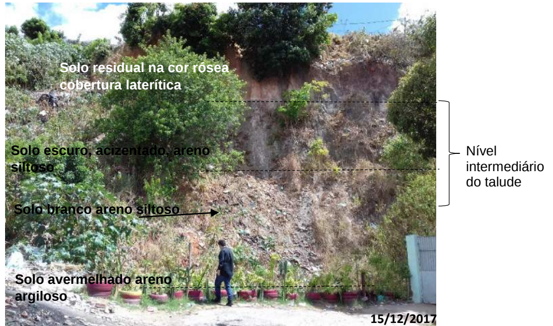
Foto 4 - Talude localizado na Bomba do Hemetério (Barreirão da Bomba), Regional Norte, Bacia Pernambuco. Coordenadas 290724/9113006UTM. Observa-se, no topo um solo eluvionar espesso, róseo e laterítico. No meio (escorregamento), um solo branco e areno-siltoso, sugerindo um dique intrusivo numa rocha de cor escura. E na base, um solo avermelhado areno argiloso.
