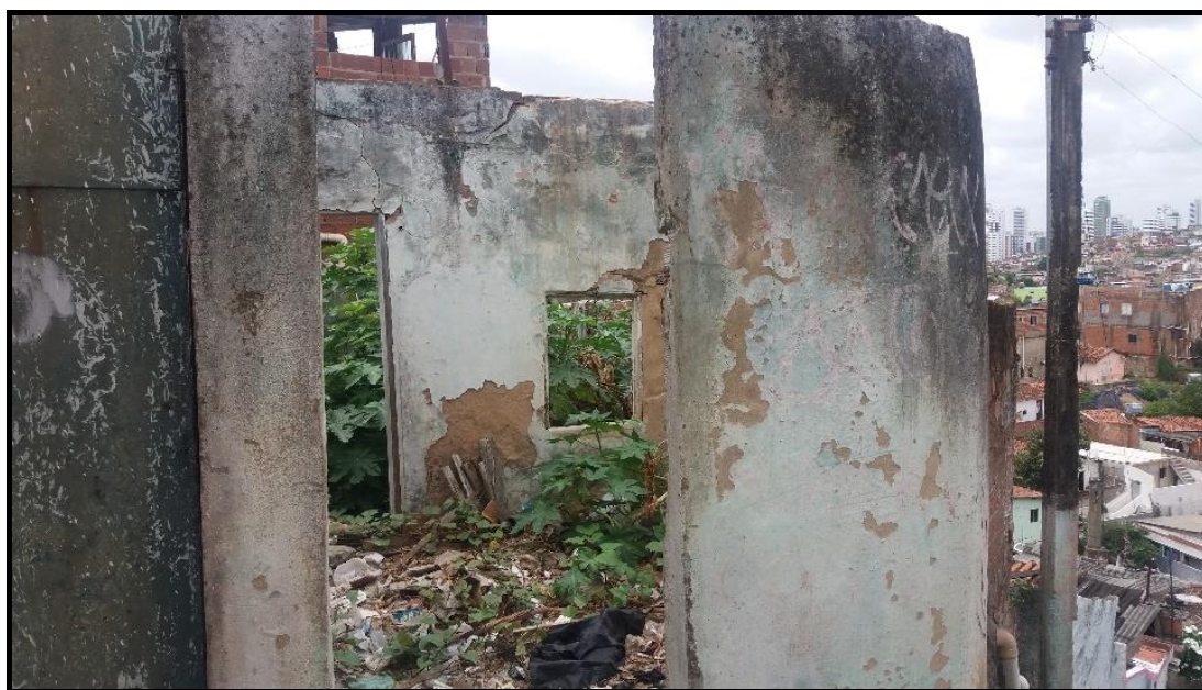
Figura 27 – Ruína da casa da vizinha acima da casa da senhora Rosa
