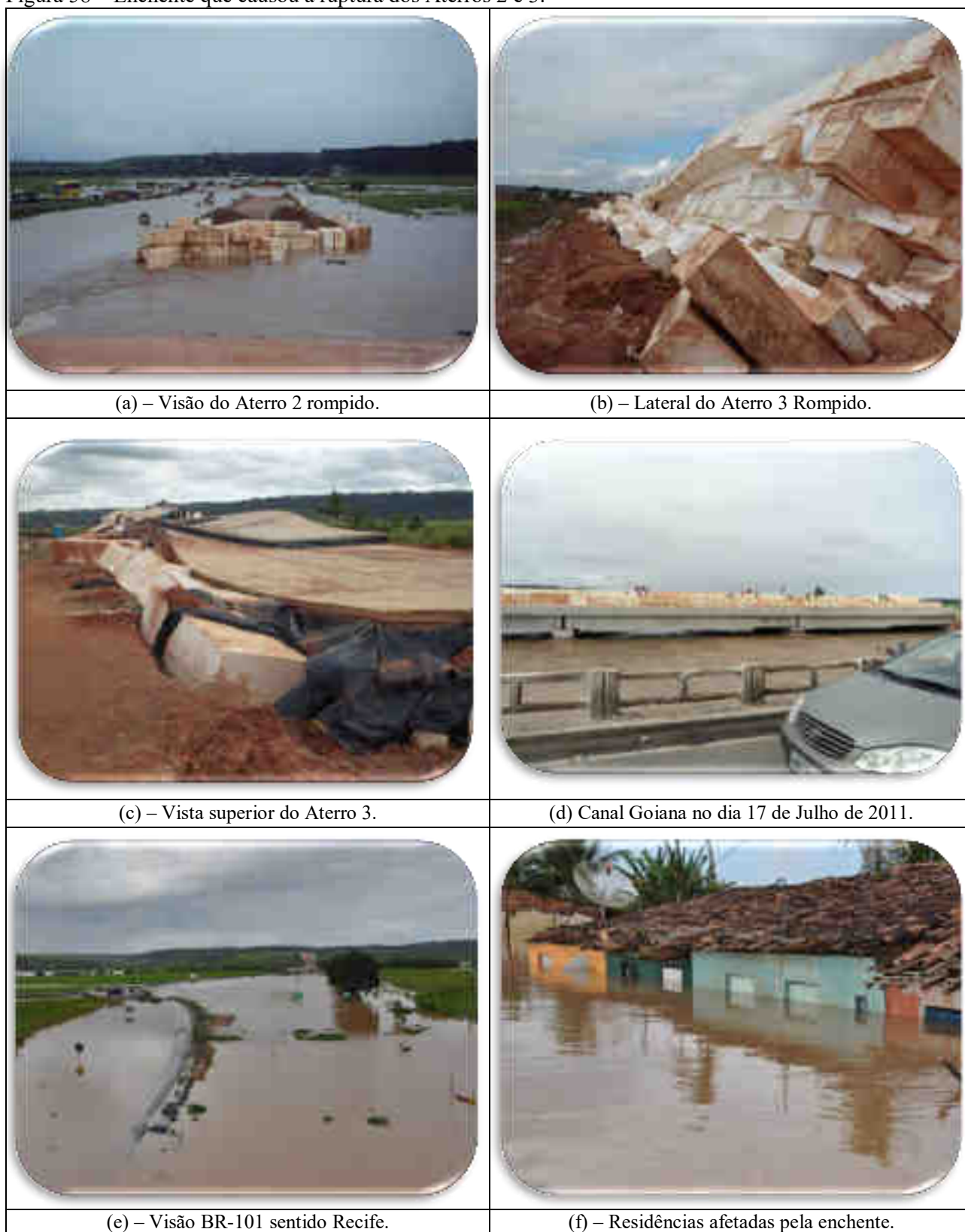
Figura 58 – Enchente que causou a ruptura dos Aterros 2 e 3.
