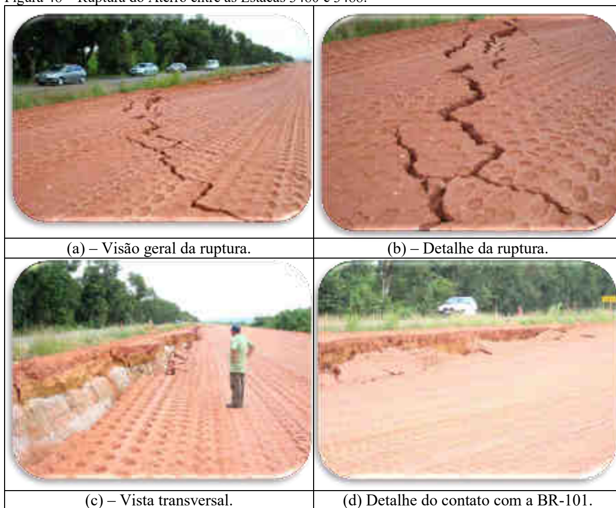
Figura 48 – Ruptura do Aterro entre as Estacas 3480 e 3488.
