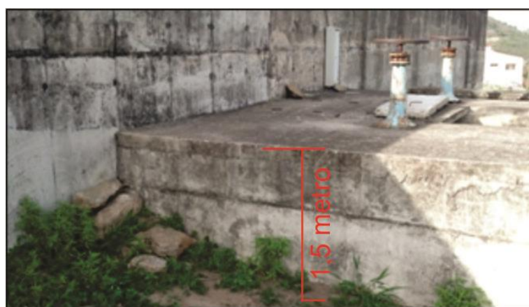
Figura 26 - Acesso a válvula de entrada de água.
