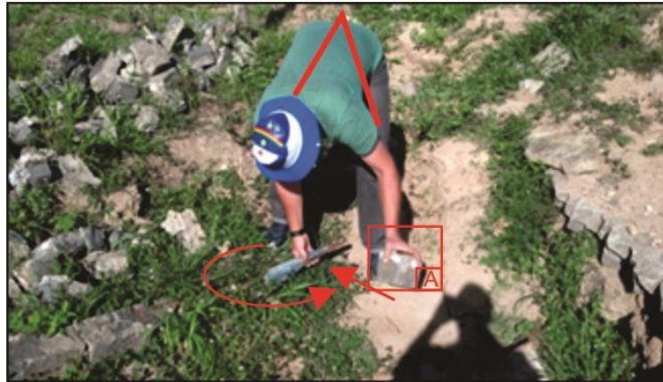
Figura 24 - Operador abrindo válvula de água tratada para Passira e Cumaru.
