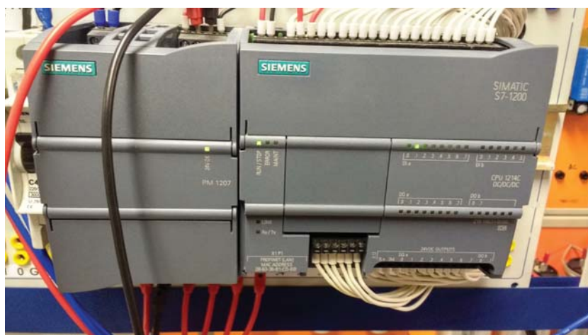
Figura 41 – Detalhe do CLP SIEMENS SIMATIC S7 - 1200.
