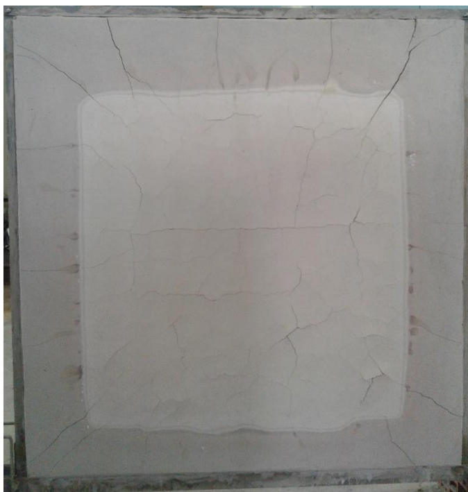
Foto 54 - Face Exposta ao Aquecimento da Parede 5 Após Ensaio Térmico e de Choque Mecânico
