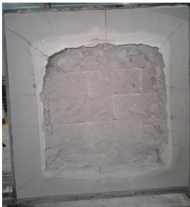
Foto 49 - Face Exposta ao Aquecimento da Parede 3 Após Ensaio Térmico e de Choque Mecânico
