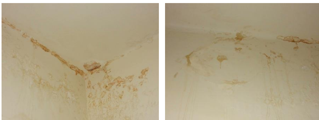
Imagem 50: Marcas de umidade na Sala Gláucio Veiga
