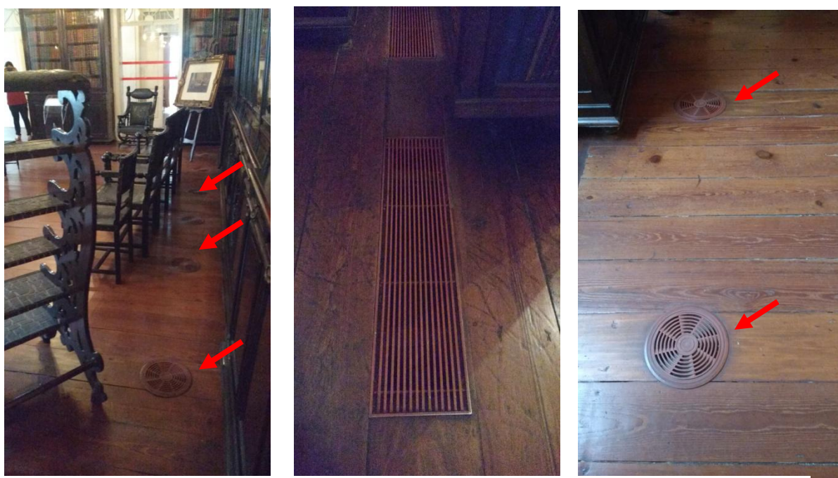
Imagem 70: Sistema de Controle Climático, Biblioteca da Casa de Rui Barbosa.
