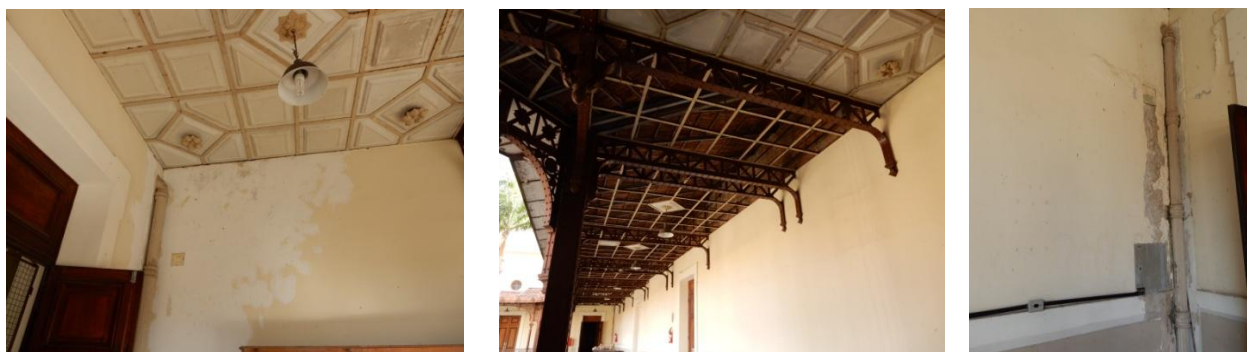
Imagem 48: Detalhe das infiltrações no terraço primeiro andar próximo a Biblioteca
