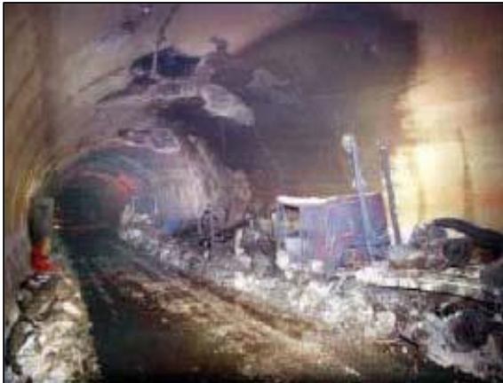
Figura 9 - Cavidades devido ao lascamento no Mont Blanc Tunnel – França/Itália (1999)
