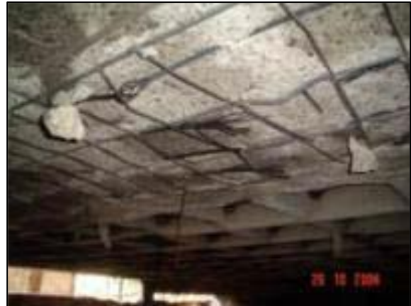
Figura 10 - Colapso parcial da estrutura dos anéis do Gotthard Tunnel induzidos por lascamento - Suíça
