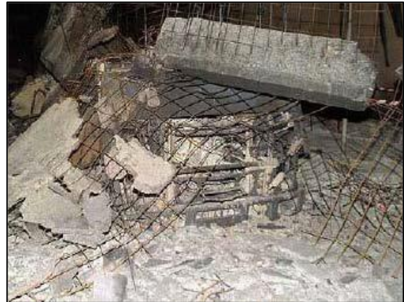
Figura 8 - Colapso parcial da estrutura dos anéis do Gotthard Tunnel induzidos por lascamento - Suíça
