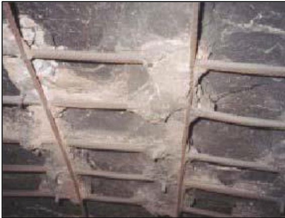
Figura 7 - Lascamento explosivo nos anéis do Channel Tunnel – França/Inglaterra (1996)
