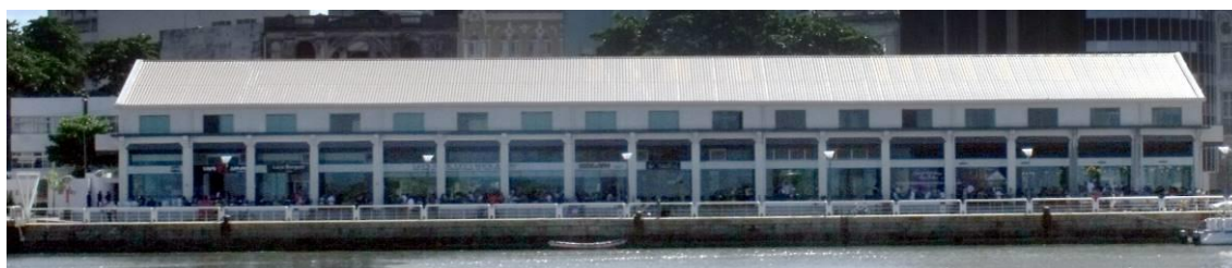
Figura 164 – As esquadrias em vidro da porção superior da edificação possuem forma retangular, diversa da quadrada proposta no projeto de arquitetura.
