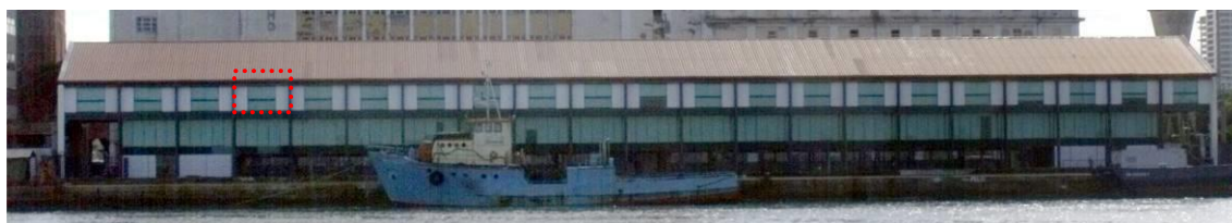
Figura 205 – Fachada posterior vista desde o molhe; forma da abertura de janela diversa da constante no projeto aprovado.
