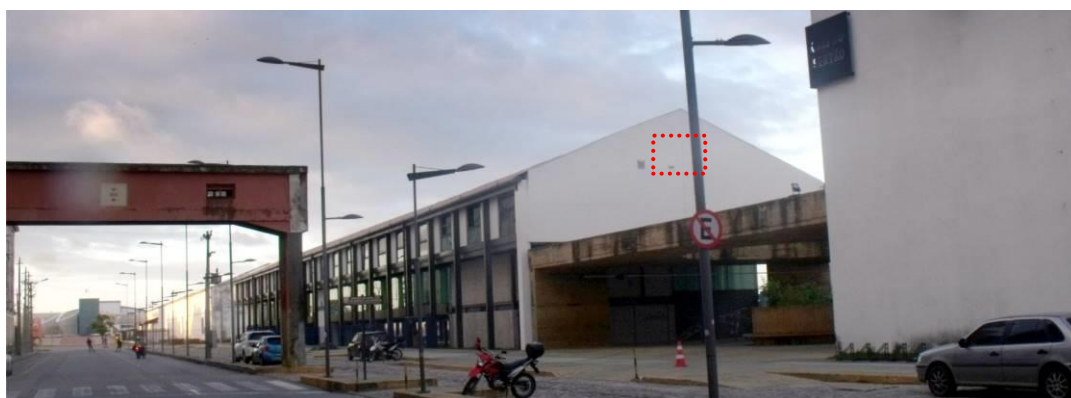
Figura 208 – Fachada lateral direita; abertura constante no projeto aprovado, não executada.
