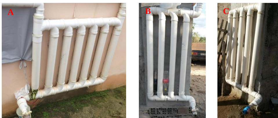
Figura 8 – Fotografia dos DesviUFPE instalados em residências situadas na área rural de Caruaru: DesviUFPE com capacidade de acúmulo de 69 L (A), DesviUFPE com capacidade de acúmulo de 51 L (B) e DesviUFPE com capacidade de acúmulo de 50 L (C).
