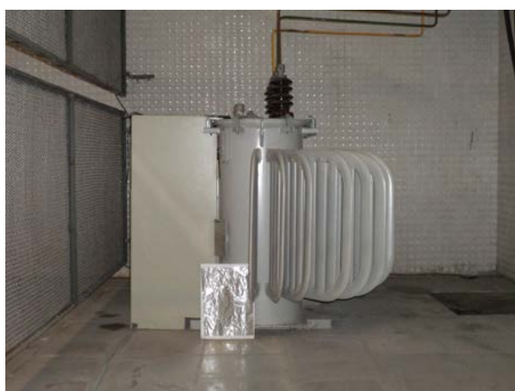
Figura 6-6: Exemplo de um transformador objeto de medição
