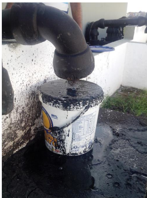
Figura 7 - Coleta de lodo em Estação de Tratamento de Efluentes.
