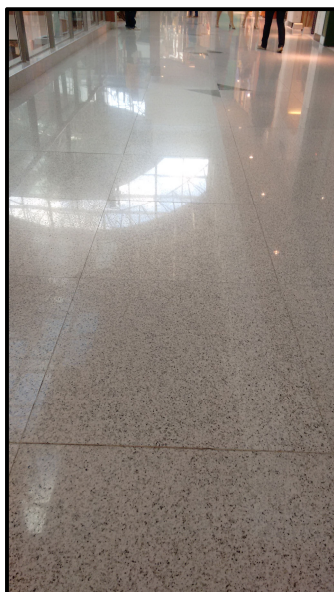
Figura 18 (4) – Piso sem Sinalização Tátil
