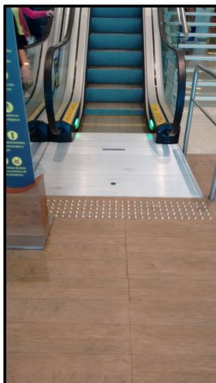
Figura 11 (4) – Entrada da Escada Rolante
