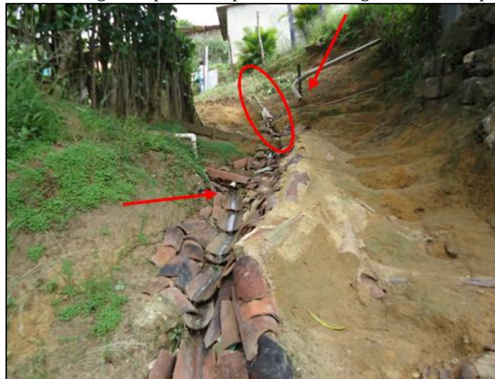
Foto 3.4 – Drenagem improvisada para destino de águas servidas e pluviais
