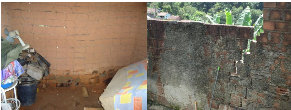
Foto 6.4 – (a) Casa com paredes de taipa. Local: Setor 2 ; (b) muro de casa com fissuras devido à ocorrência de deslizamento. Local: Setor 2.
