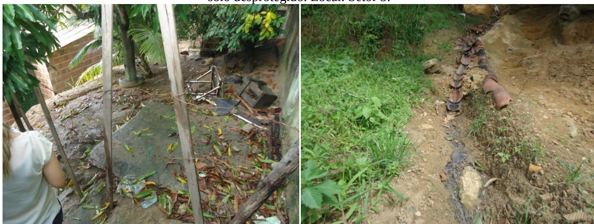
Foto 6.7 – (a) Construção de fossa rústica em encosta. Local: Setor 11; (b) Lançamento de águas servidas sobre o solo desprotegido. Local: Setor 3.
