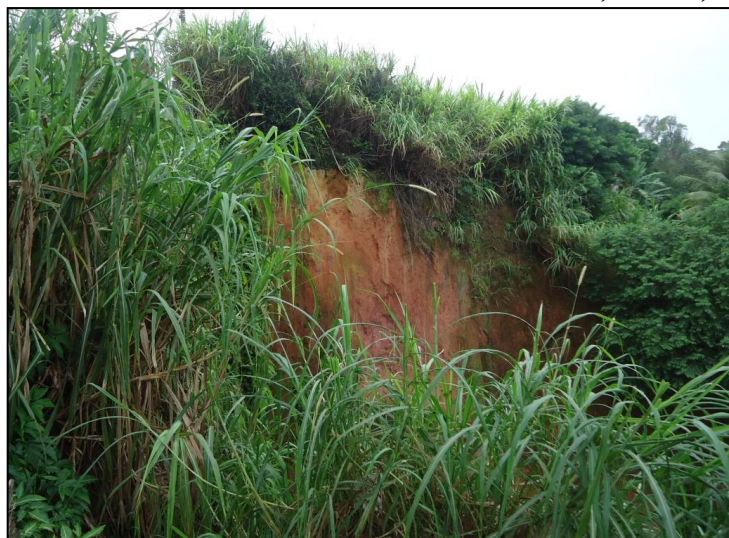
Foto 4.3 - Processo erosivo em Latossolo Amarelo. Local: Rua 137, Caetés I, Abreu e Lima
