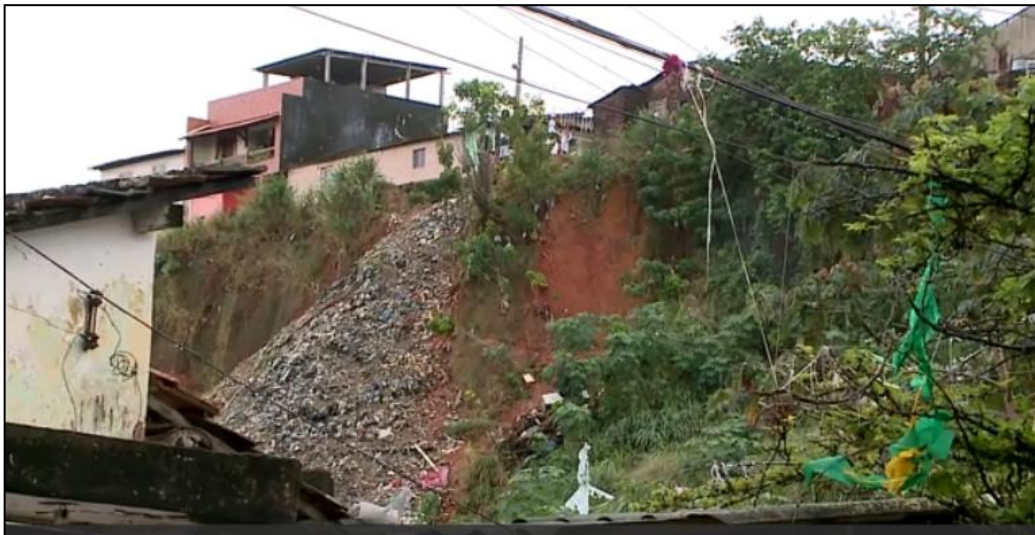
Foto 3.2 - Deslizamento de encosta com acúmulo de lixo. Local: Bomba do Hemetério-Recife.
