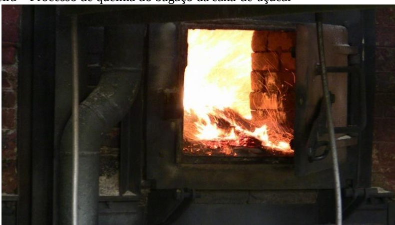
Figura 3.2 - Caldeira – Processo de queima do bagaço da cana-de-açúcar
