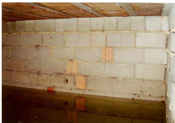
Figura 1.7 – Caixão vazio sob laje de piso do pavimento térreo - micro clima favorecendo elevada agressividade (MINISTÉRIO PÚBLICO DE PERNAMBUCO, 2010)
