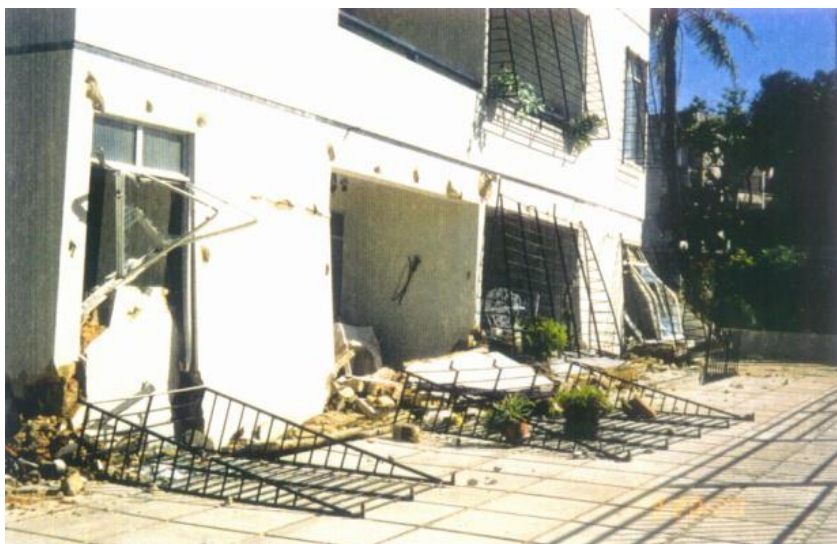
Figura 2.1 – Ruptura dos embasamentos
